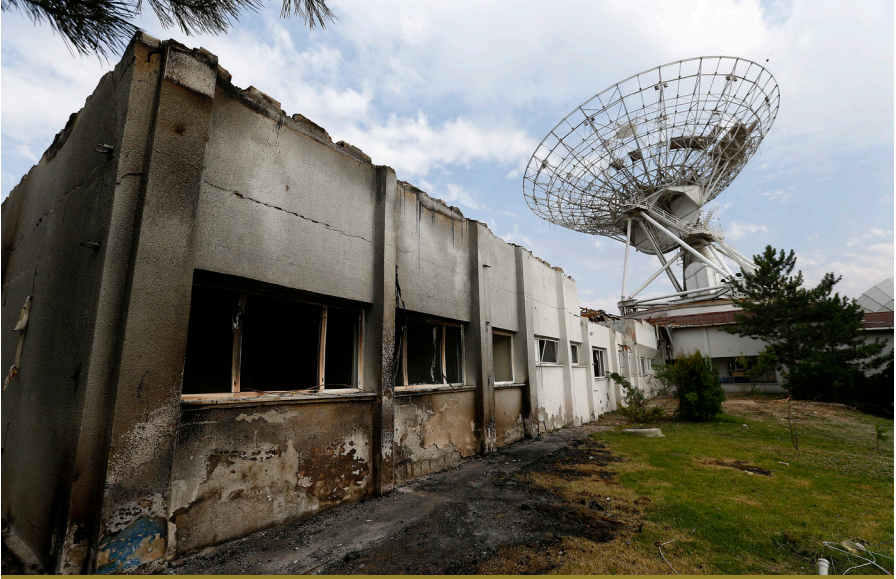
TÜRKSAT Binası (2 kişi öldürüldü)
